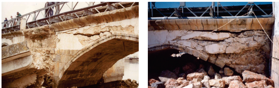
Figura 2 - Vista da destruição de um talhamar e de 2 arcos
