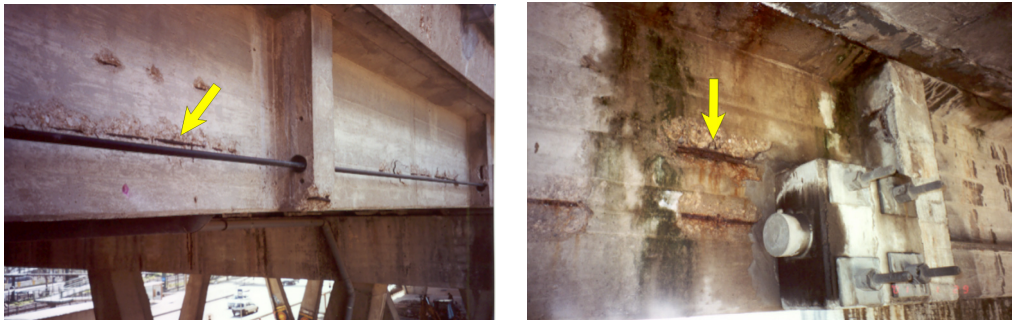
Figura 2: Deterioração por corrosão de armaduras
