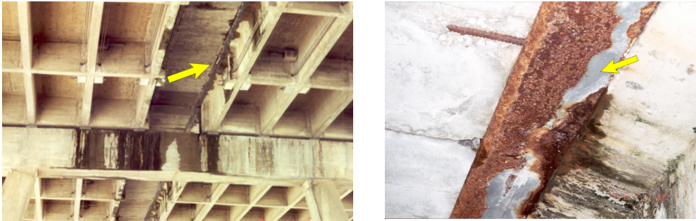
Figura 3: Infiltrações e deterioração do perfil de apoio da laje do separador central
