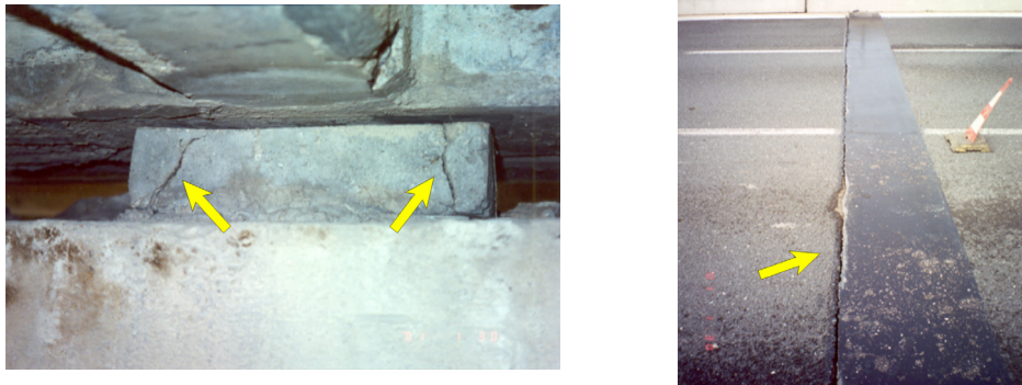
Figura 6: Danos no novo sistema de apoio do tabuleiro e na junta de dilatação
