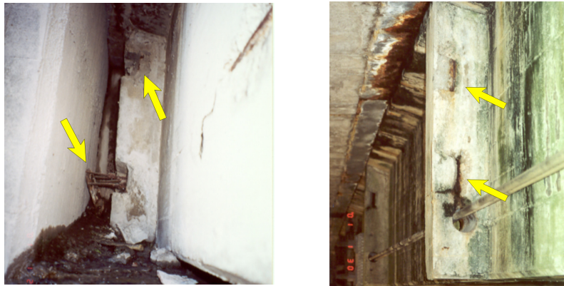
Figura 4: Deterioração das ancoragens dos cabos de pré-esforço das carlingas
