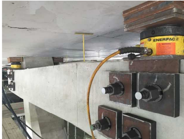
Figura 5. Montagem dos macacos hidráulicos e instalação de barras de pré-esforço (provisórias) para ligação entre a viga e os pilares
