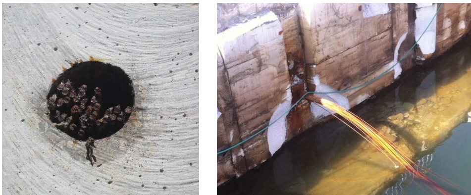
Fig. 12 – Cabos de pré-esforço não injectados
