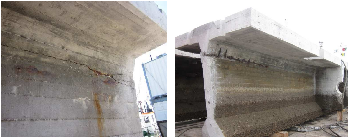
Fig. 9 – Fendas longitudinais na alma das vigas ao nível do cabo superior
