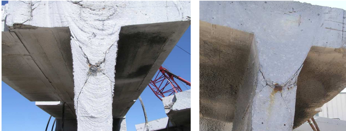
Fig. 8 – Tipo de fendilhação observada na zona do cabo de pré-esforço superior
