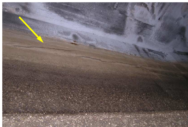
Fig. 6 – Fenda longitudinal na zona superior da alma da viga
