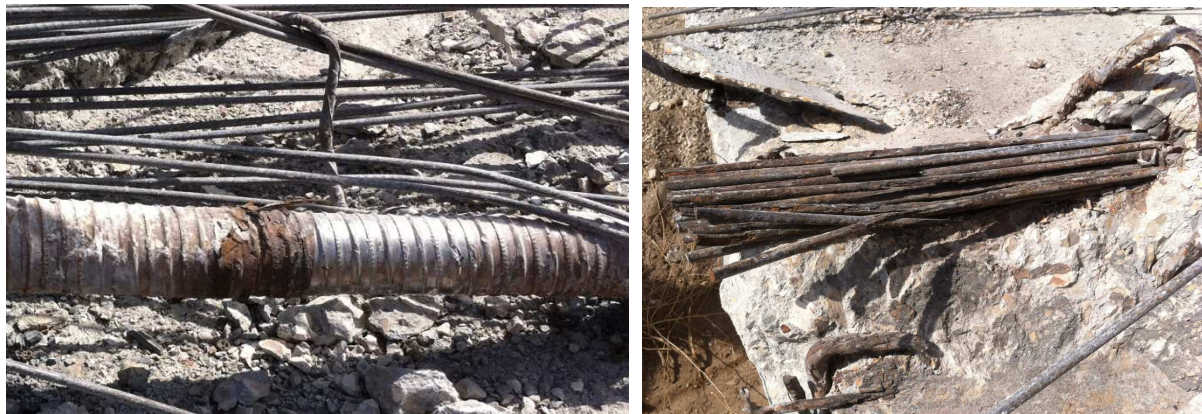
Fig. 11 – Bainha corroída localmente e corrosão elevada dos fios de pré-esforço
