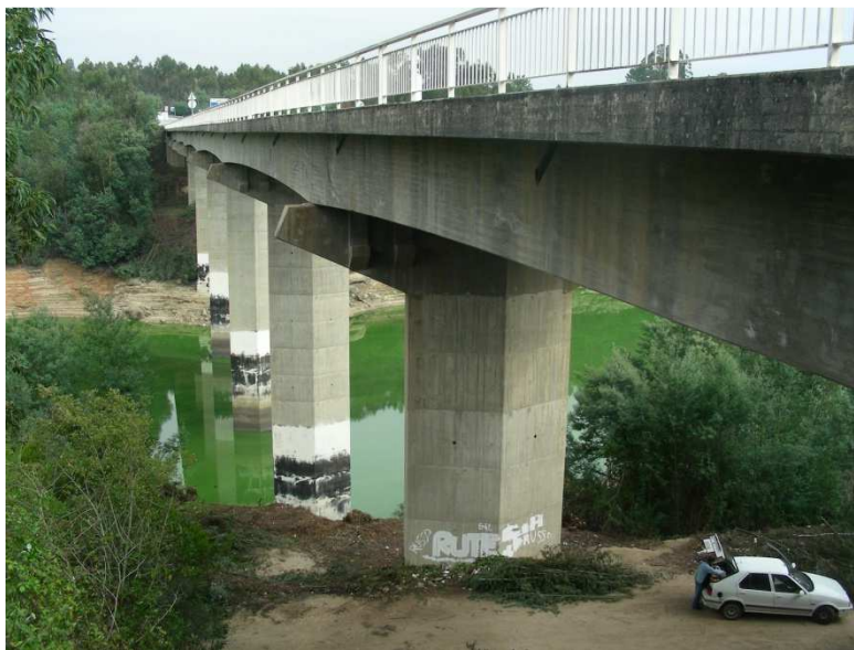
Figura 1. Fotografia do viaduto antes da intervenção.
