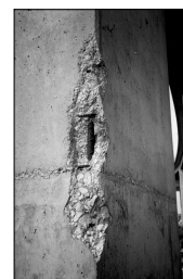
Armaduras de canto expostas devida à corrosão no pilar P9
