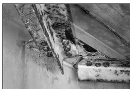
Pomenor da deterioração num nó de ligação
