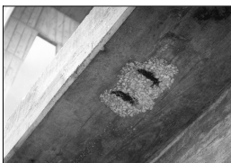
Armadura à vista na face inferior da viga de travamento de um mastro
