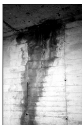
Infiltrações de água no tableiro
