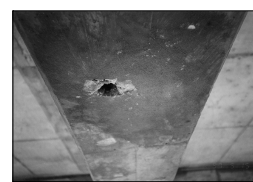
Chocho na face inferior da viga
