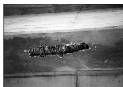
Chochos na face inferior da viga
