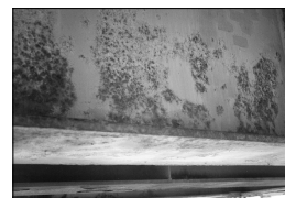
Deterioração do sistema de Pintura da estrutura metálica
