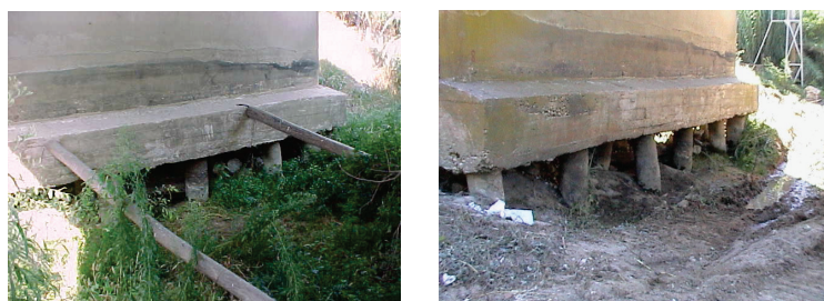
Figura 2 - Infraescavações colocando à vista as estacas de betão
