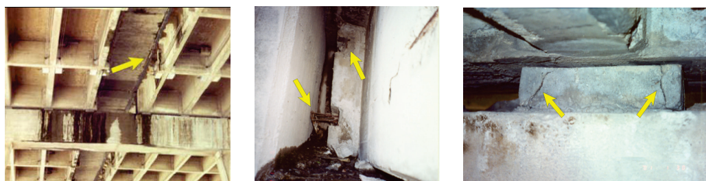
Figura 3 - Infiltrações e deterioração da laje do separador central e das ancoragens do pré-esforço das carlingas
