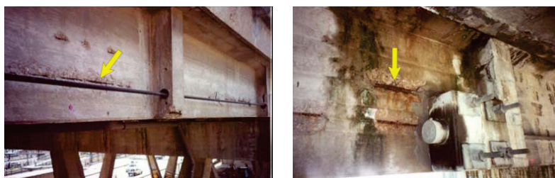
Figura 2 - Deterioração por corrosão de armaduras
