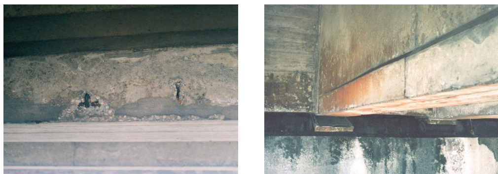
Figura 2 - Anomalias no betão e em aparelhos de apoio
