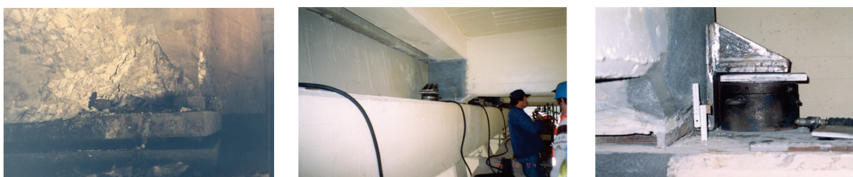
Figura 4 - Danos nos aparelhos de apoio e levantamento do tabuleiro
