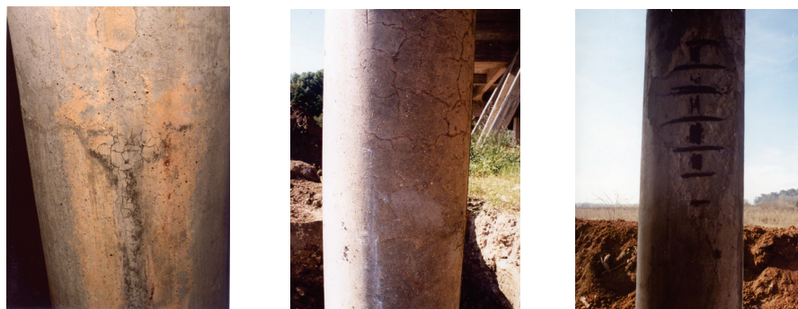
Figura 2 - Reacções expansivas nos pilares-estacas
