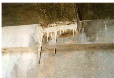
Figura 4 - Infiltrações de água no tabuleiro
