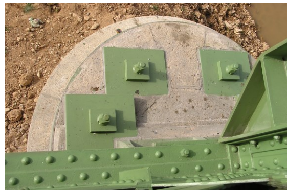
b) Visto da face superior do pilar sob os apoios fixos com as novas pregagens verticais
