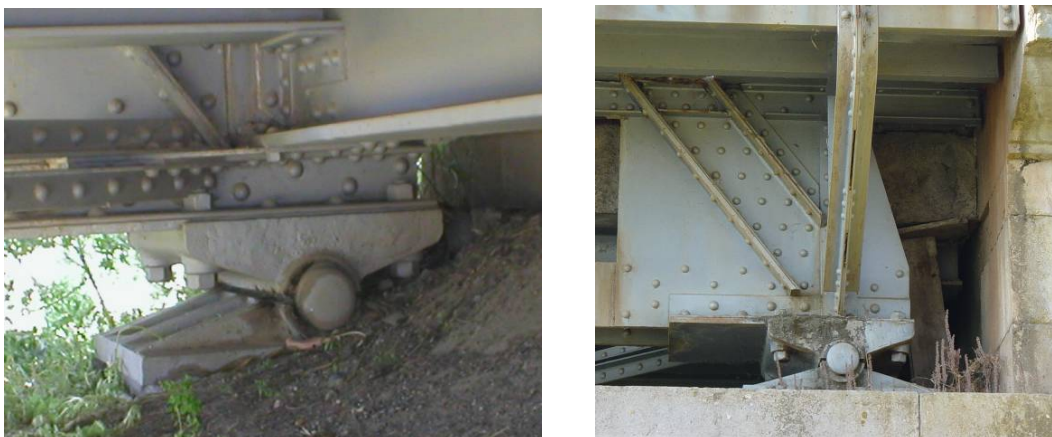
Figura 10 – Aparelhos de apoio envolvidos por detritos na Ponte de Sta Margarida do Sado
