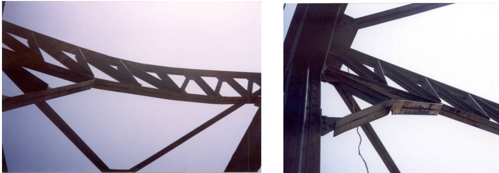
Figura 8 – Danos nas treliças de travamento das cordas superiores na Ponte General Teófilo Trindade
