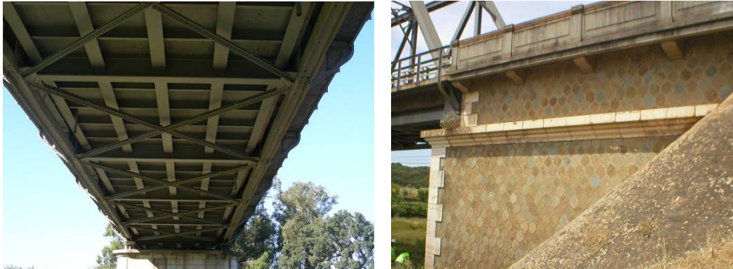
Figura 4 – Grelha inferior do tabuleiro e encontro em alvenaria da Ponte de Sta Margarida do Sado
