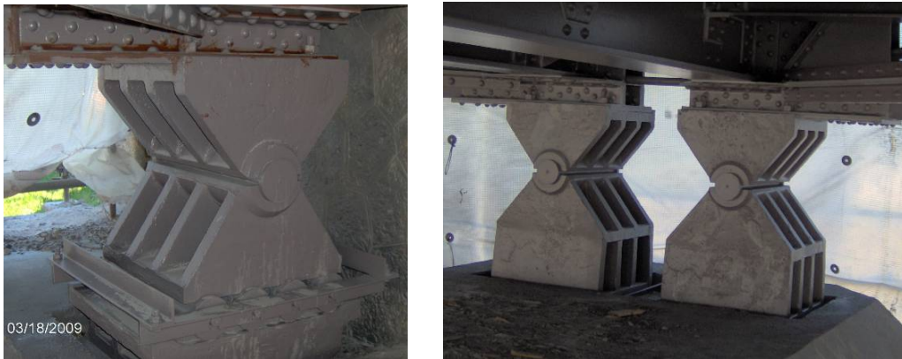
Figura 5 – Aparelhos de apoio móveis e fixos da Ponte da Raposa
