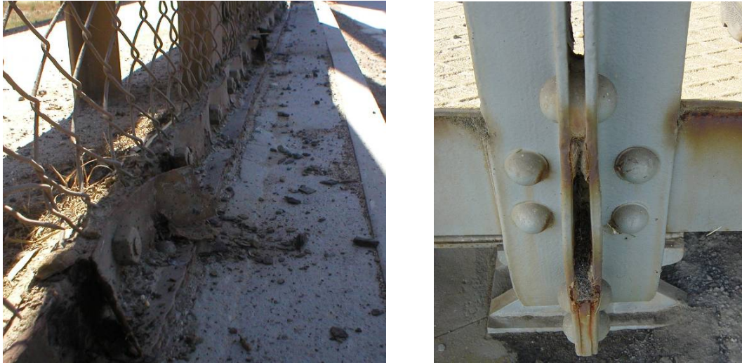
Figura 6 – Corrosão dos elementos metálicos secundários - guardas
