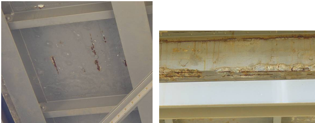
Figura 7 – Corrosão de armaduras na face inferior da laje
