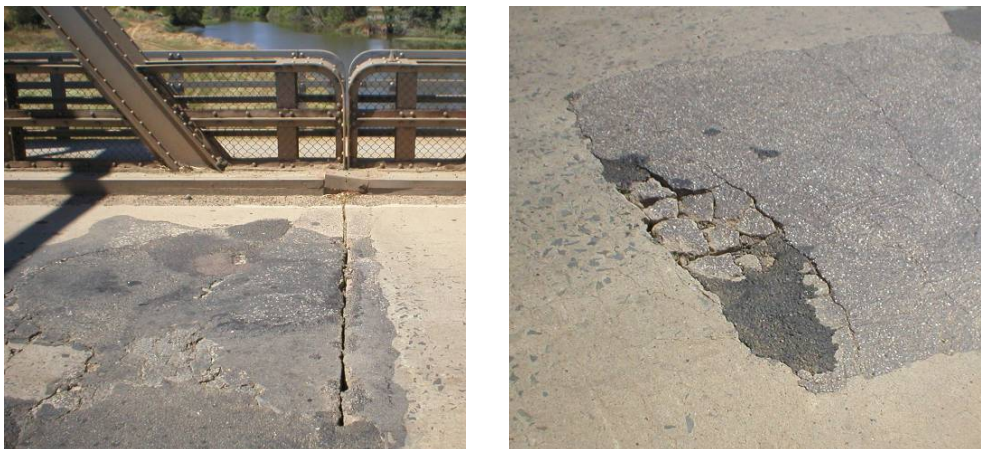
Figura 9 – Camada de betão de enchimento no tabuleiro deteriorada
