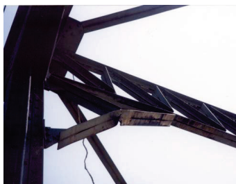
Figura 3 - Cantoneiras de travamento cortadas por embate de veículos pesados
