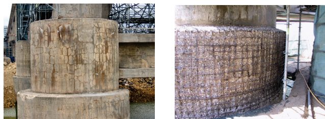
Figura 6 - Anomalias e reforço dos maciços de apoio dos mastros
