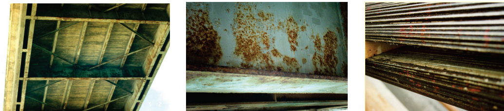
Figura 3 - Anomalias e inspecção do interior de um tirante
